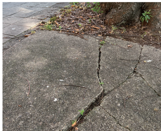
根上がりによる歩道のひび割れ
