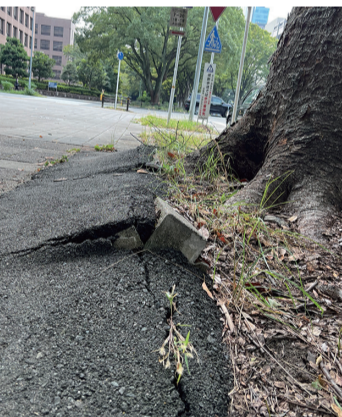
根上がりによる歩道の浮き上がり
